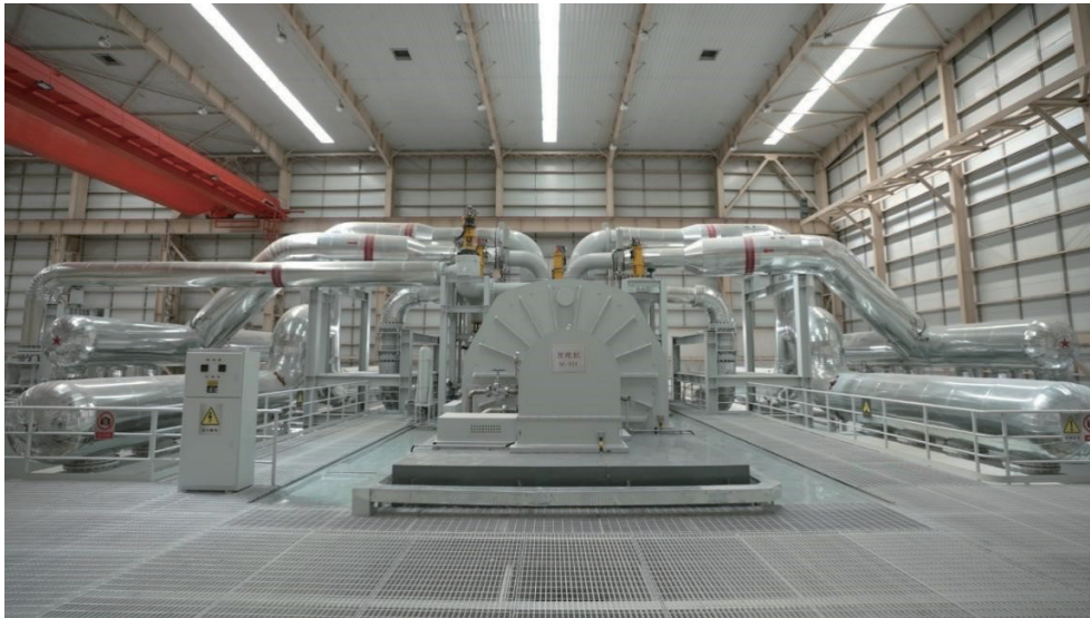
公司压缩空气储能系统现场装备图
